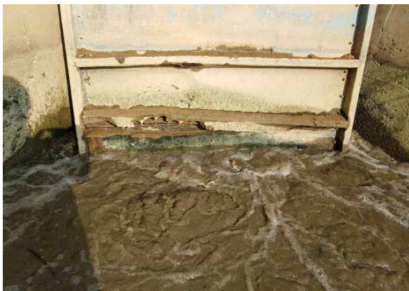
Flab문짝 보강재 파손
